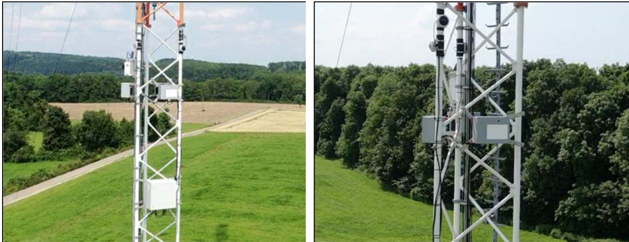
Abbildung 10: Fotos der Sensorinstallation am WINSSENT aus zwei unterschiedlichen Richtungen.
