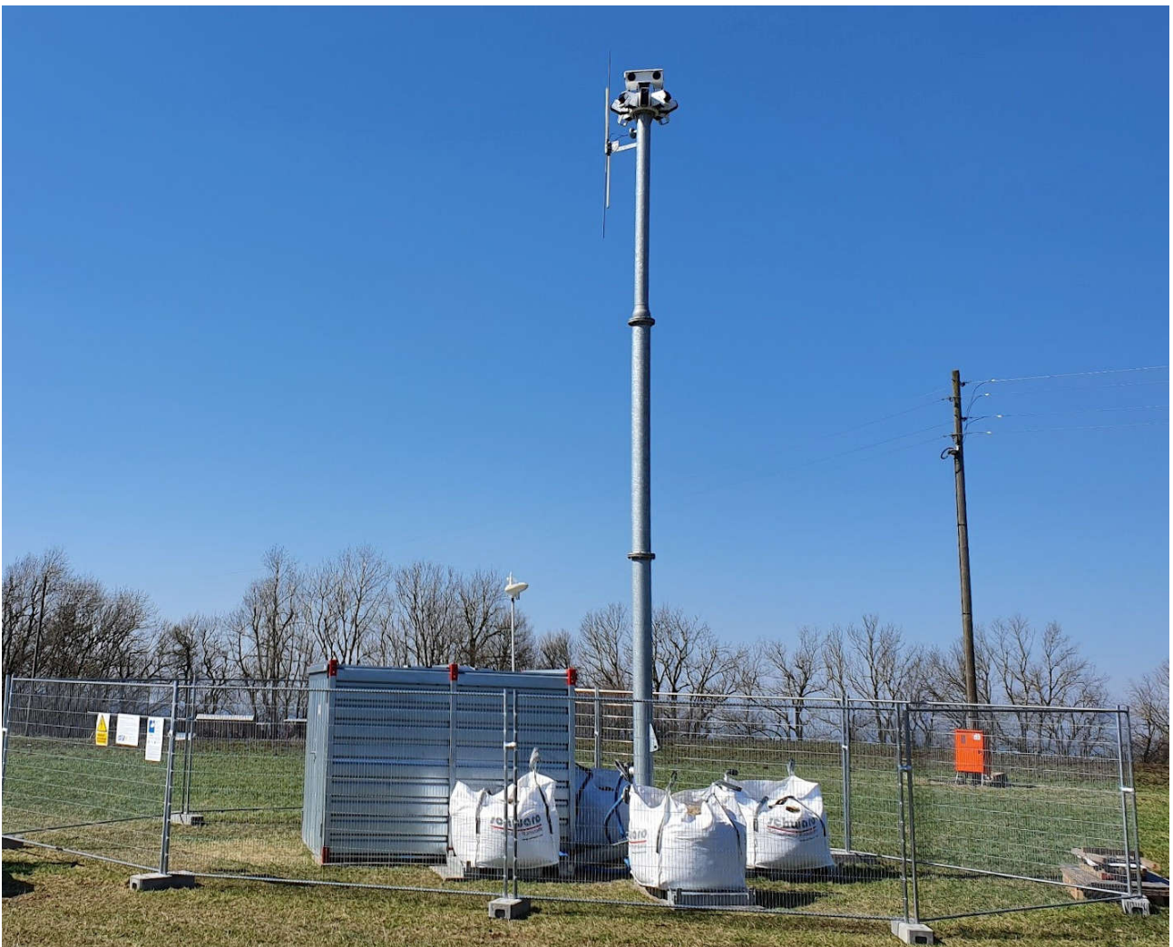
Abbildung 1: Installiertes IDF-System mit einer Masthöhe von 10 m.
